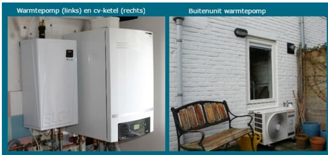
Hybride warmtepomp met CV-ketel en buitenunit (ventilator onder het raam).
