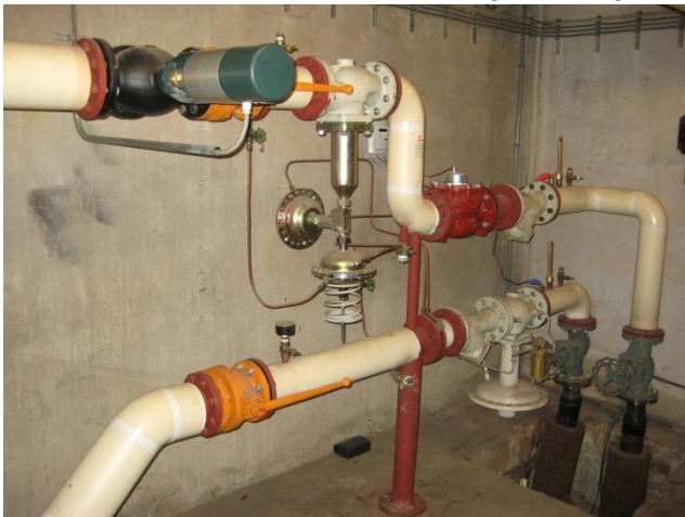
Foto 2-1: Afleverstation stadsverwarming Tafelbergdreef.
