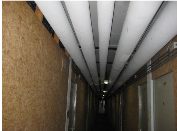
Foto 2-3: Leidingnet onderste bouwlaag (Rhodosdreef)
