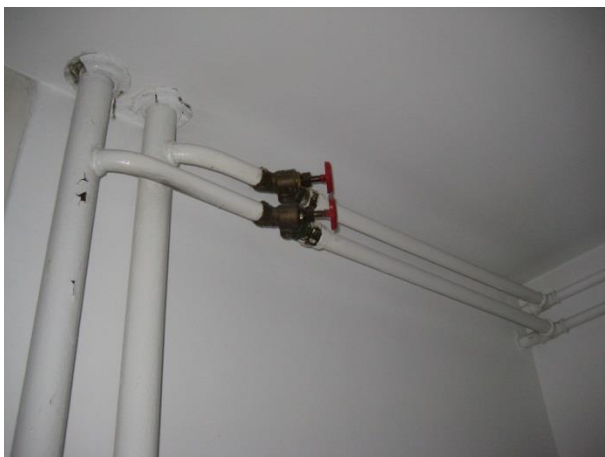
Foto 2-4: Stijg-/zakleiding per woning.
