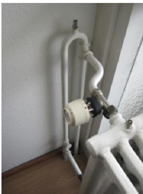
Foto 2-6: Doorverbonden leiding bovenste bouwlaag.
